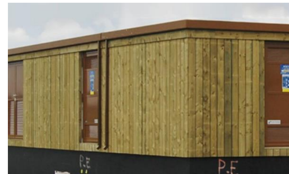
Figure 19 : Illustration du poste de livraison, bardage vertical bois naturel avec des portes marron / rouille
