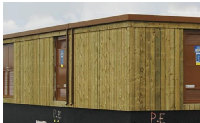
Figure 12 : Illustration du poste de livraison du parc éolien de « La Vallée de Torfou » (source : EPURON, 2013)
